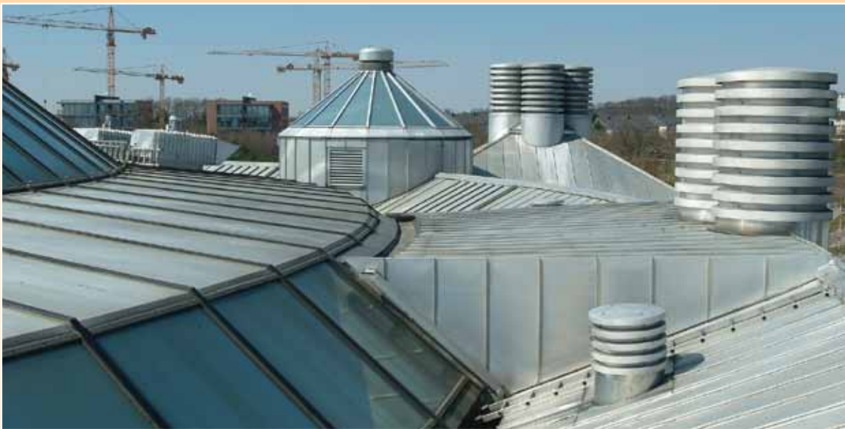
Prise et rejet d'air pour les tours de refroidissement intégrés à la toiture
