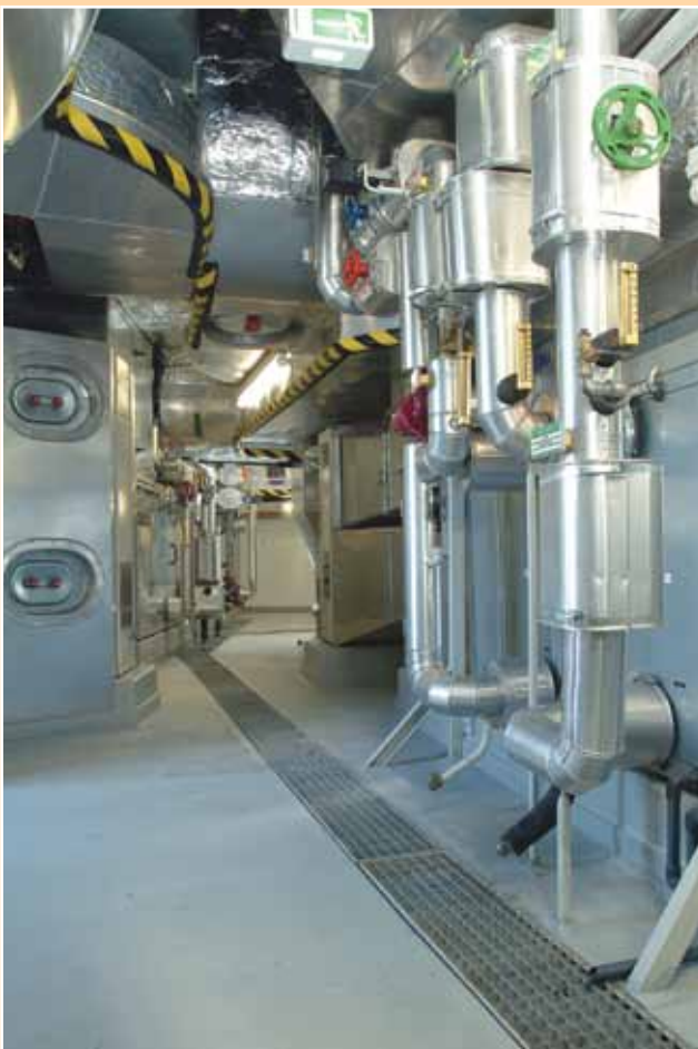
Groupe de ventilation dans les combles sous toiture
