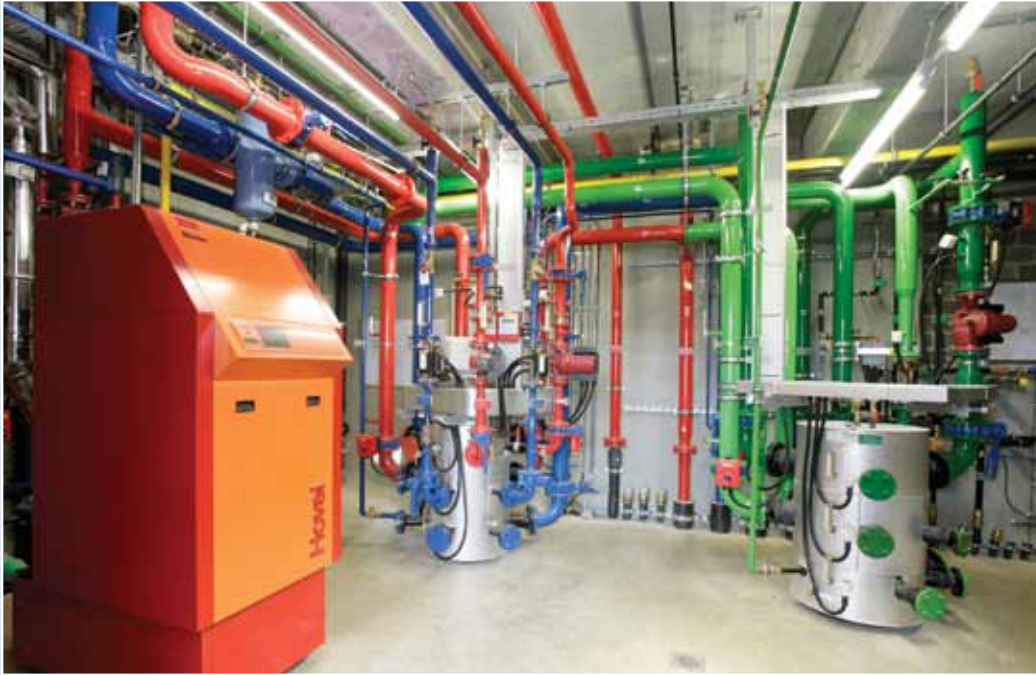
Chaudière à condensation et collecteur: puissance 123 kW
