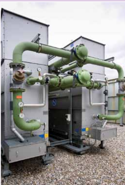
Tours de refroidissement
