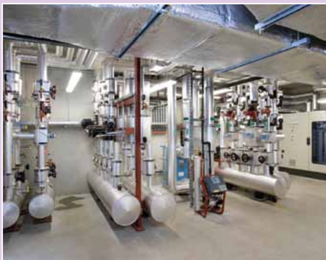
Collecteurs de distribution extension médicale
