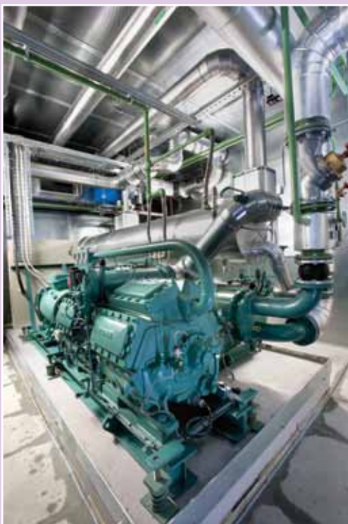
Machine frigorifique à l'ammoniac puissance 369kW
