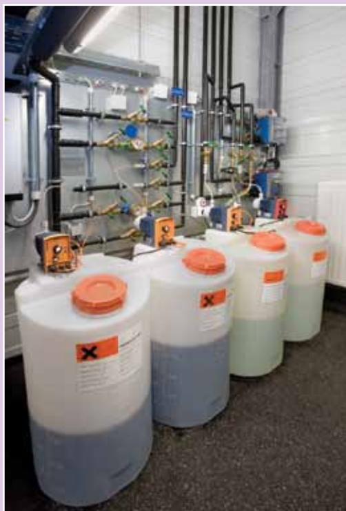
Traitement d'eau des tours de refroidissement
