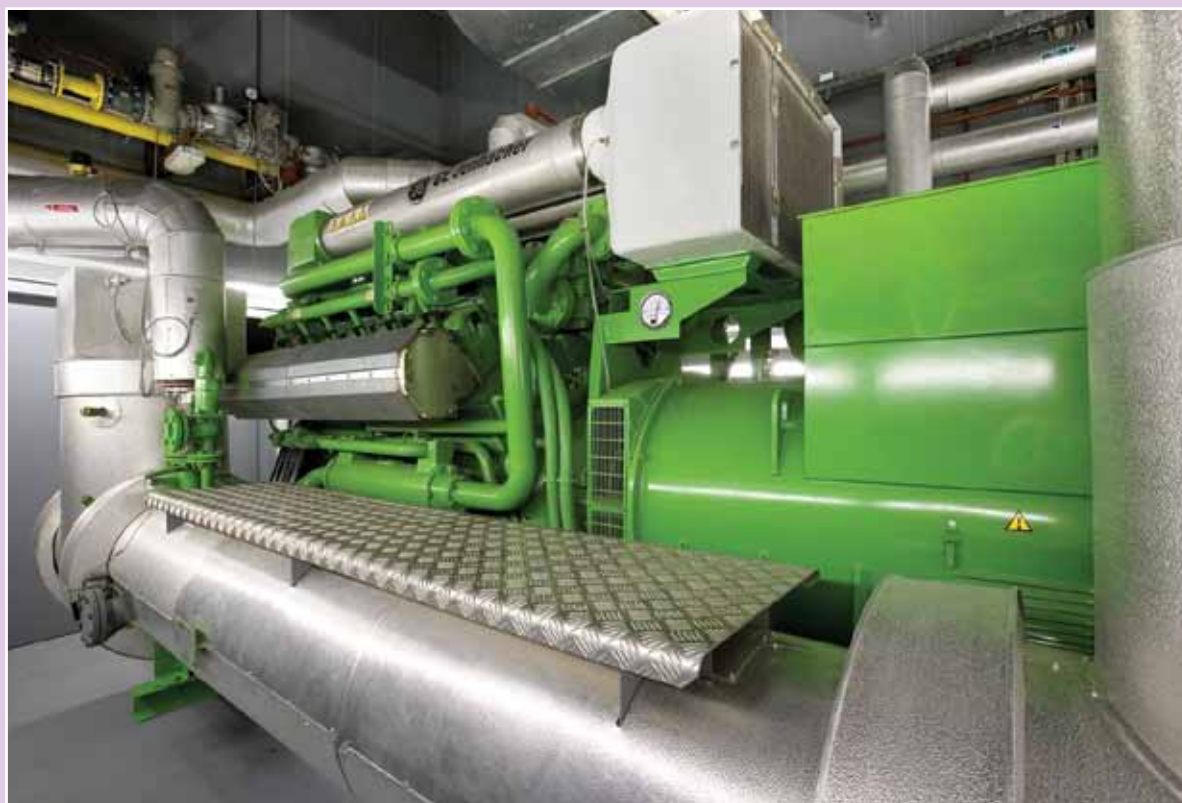
Moteur de cogénération
