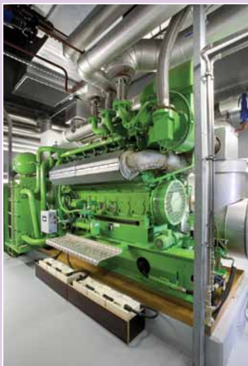
Moteur de cogénération
