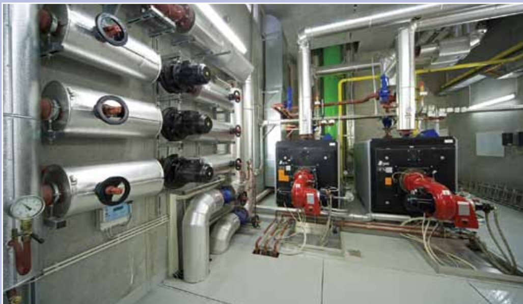
Chaudière et distribution principale de chaleur
