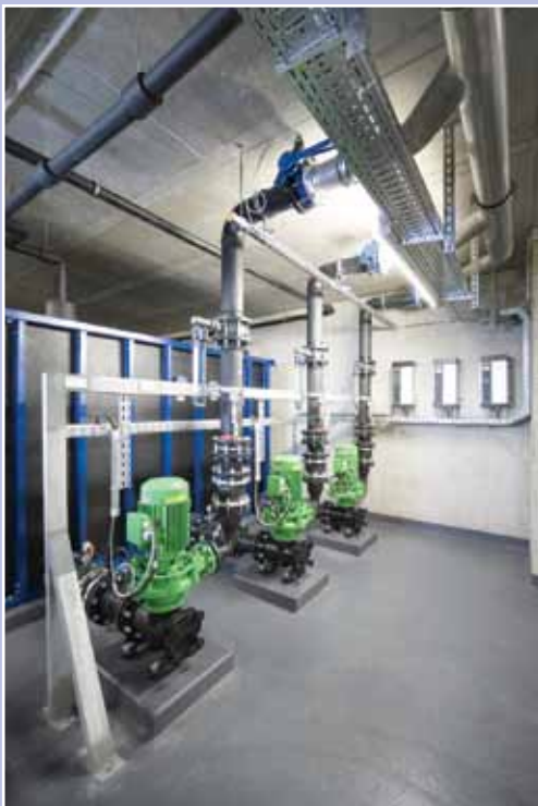
Pompes eau de piscine
