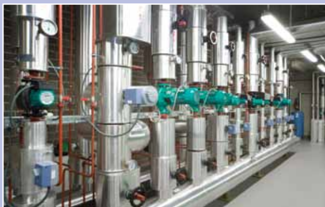
Collecteur de chauffage du bâtiment
