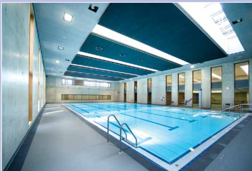
Piscine de 25 mètres avec filtration classique
