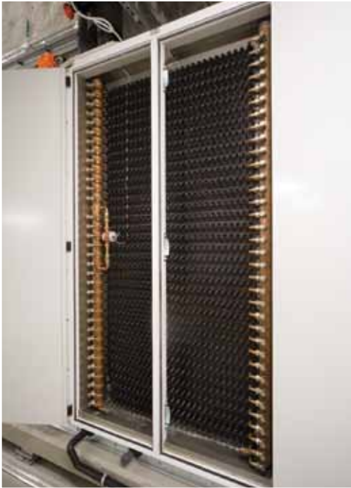
Batterie adiabatique dans la reprise de l'air vicié
