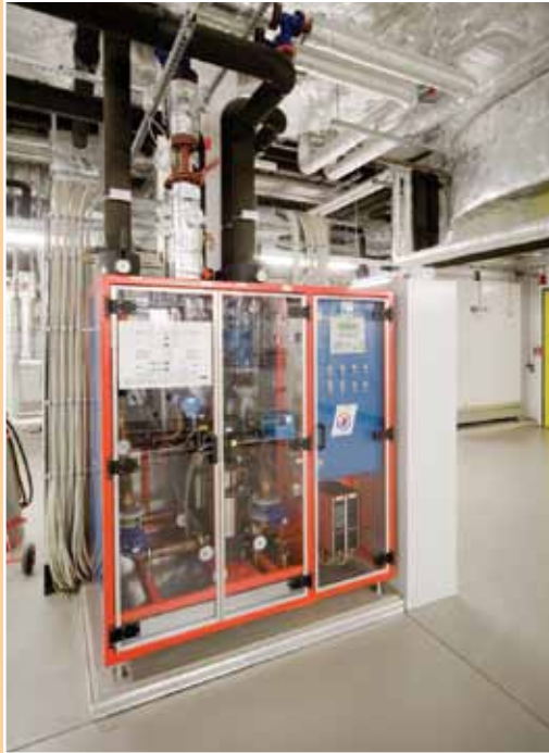
Système de récupération d'énergie
