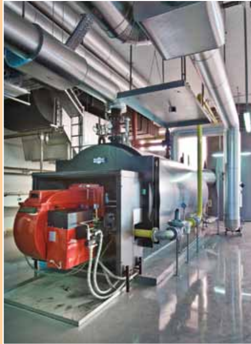
Chaudière mixte 4,7 MW
