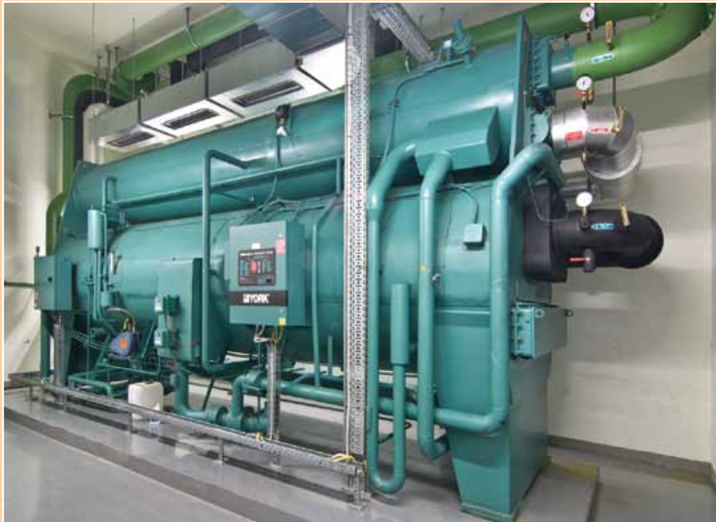
Machine à absorption de 900 kW
