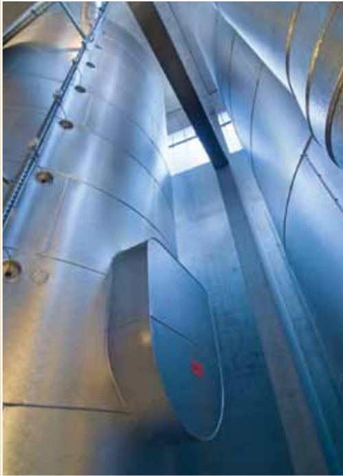
Réservoirs de stockage chaleur de 360.000 litres
