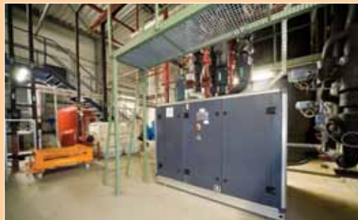
Production d'eau glacée
