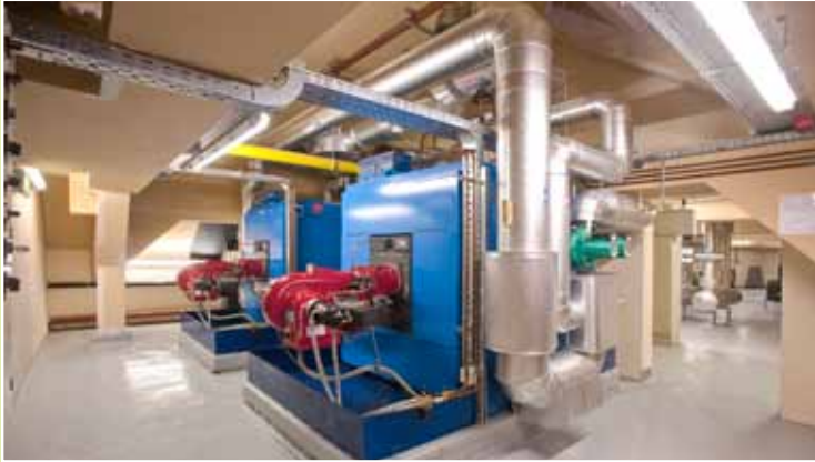
Chaufferie dans les combles
