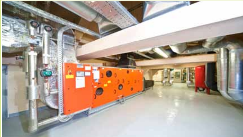
Climatisation des ateliers
