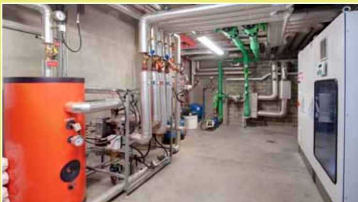
Préparation eau chaude sanitaire
