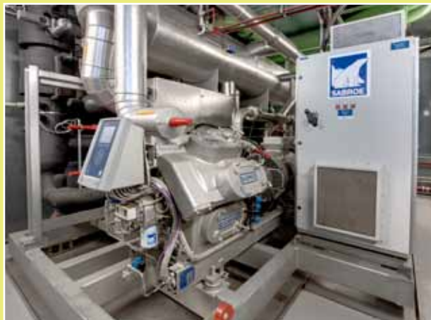
Local « Production Froid » : Une machine de production froid à l'ammoniac de 2 x 850 kW avec les équipements de sécurité
