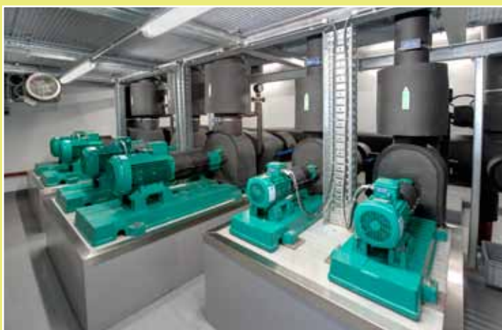
Les pompes de distribution de l'eau glacée : 2 x 2 pompes assurent l'alimentation en eau glacée des locaux « server » 2 x 1 pompe assure l'alimentation en eau glacée des groupes de ventilation
