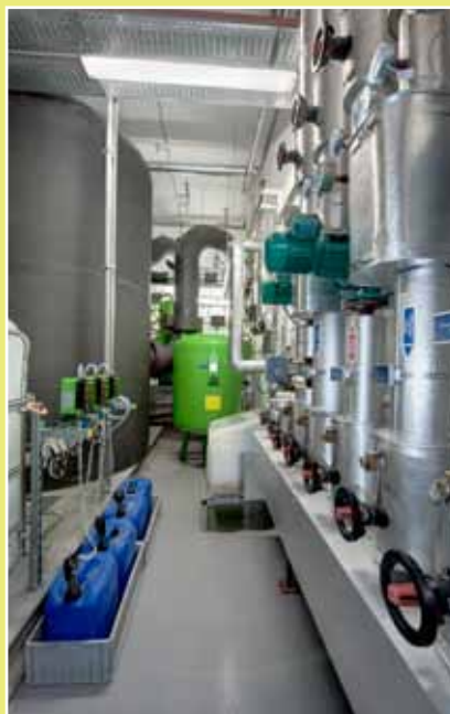
Local Technique : collecteur chauffage assurant la distribution de chaleur réservoir de stockage d'eau glacée de 20 m 3 installation de traitement d'eau des circuits fermés
