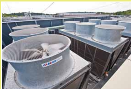
Sur la terrasse : les tours hybrides assurent le refroidissement de la production froid
