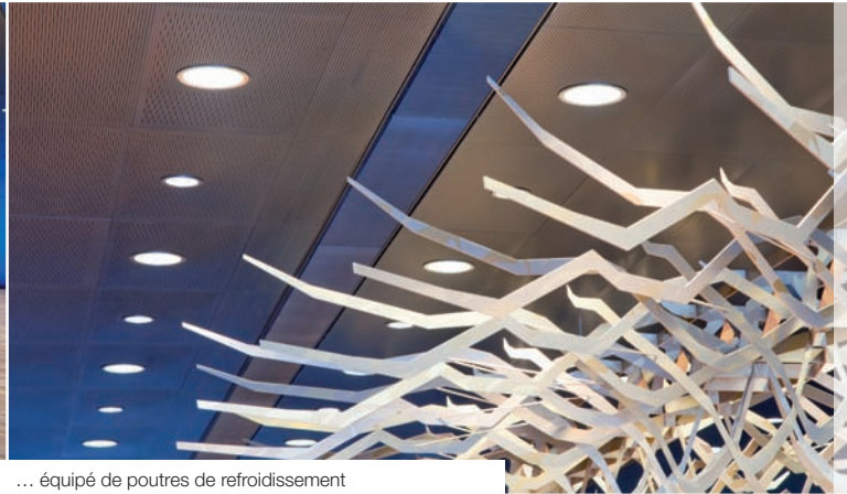
... équipé de poutres de refroidissement
