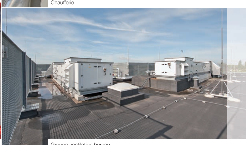
Groupe ventilation bureau
