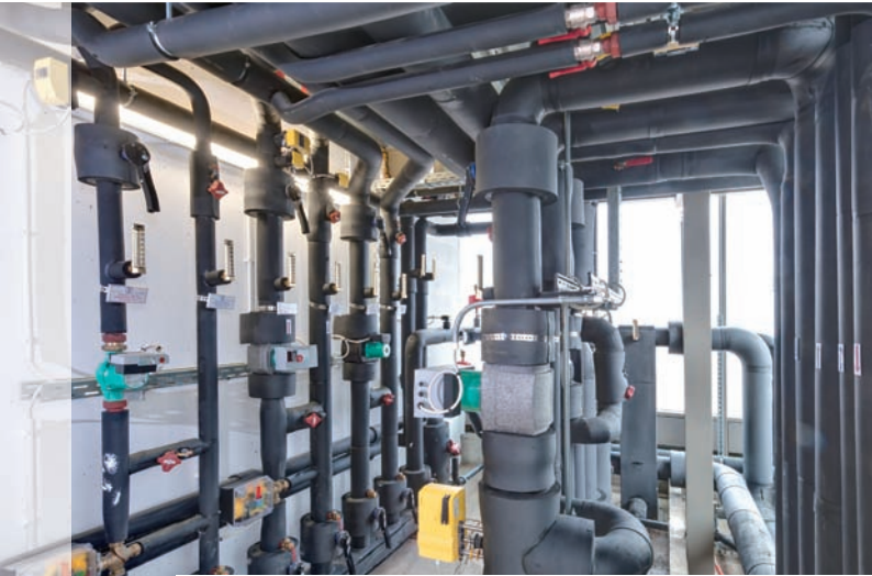
Distribution d'eau de chauffage et d'eau glacée
