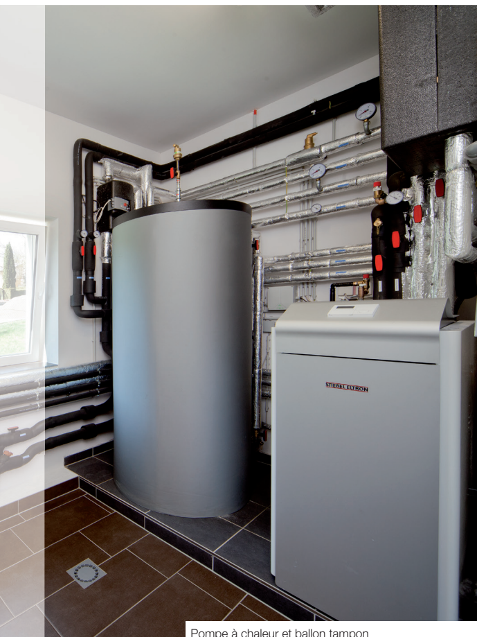
Pompe à chaleur et ballon tampon
