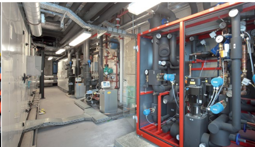
6 e étage / Local technique - centrale de traitement d'air et système de récupération d'énergie
