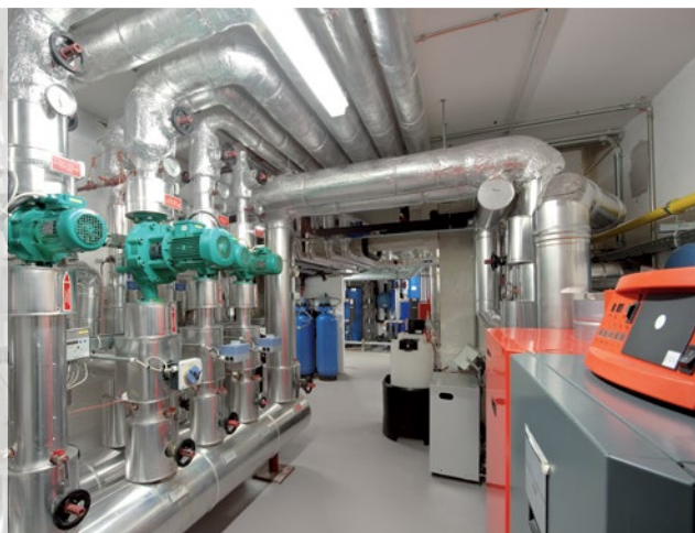
Niveau -4 / Chaufferie - collecteur chauffage et chaudière à condensation
