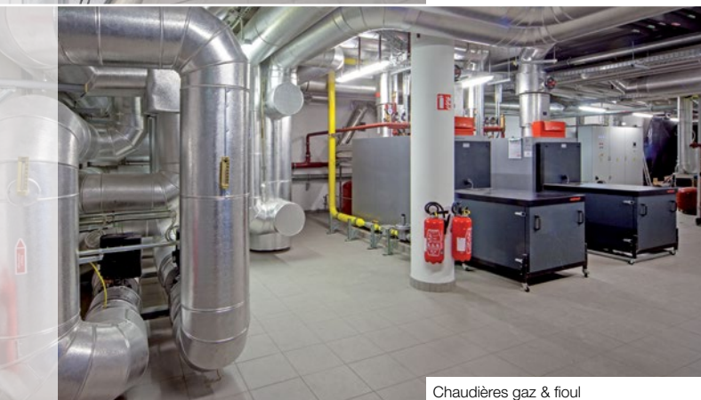
Chaudières gaz & fioul
