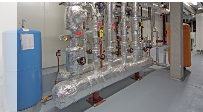
Local technique 2° étage / collecteur chaud
