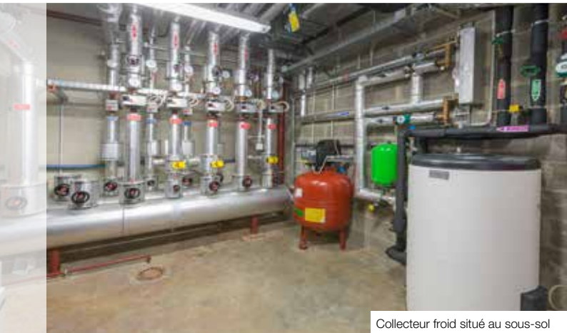
Collecteur froid situé au sous-sol
