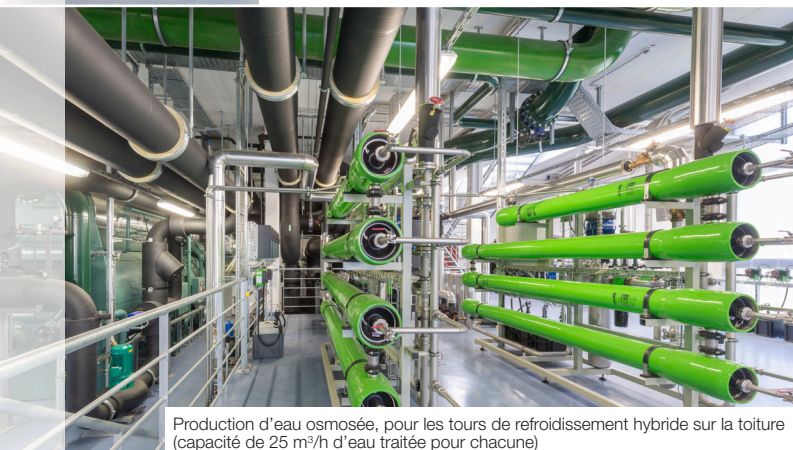
Périphérie ou rez-de-chaussée, avec les vases d'expansion à gauche et production osmose à droite
