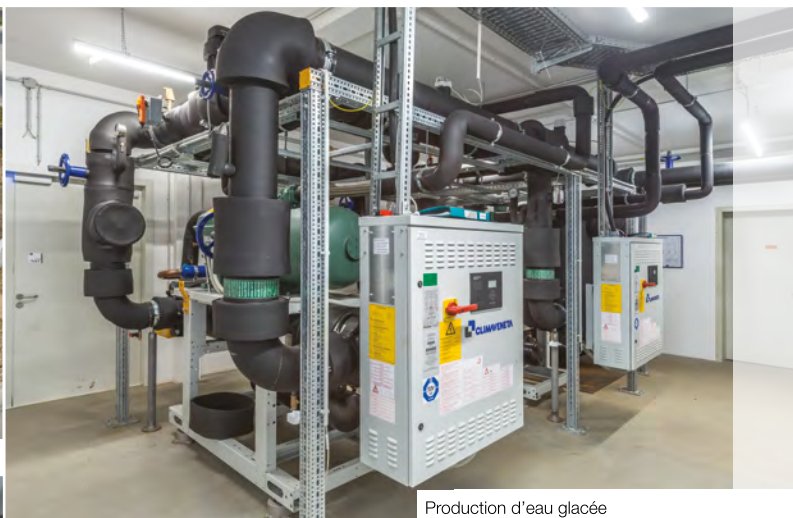
Production d'eau glacée
