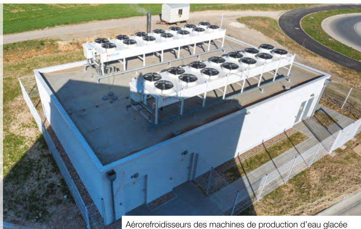
Aéroréfrigérateurs des machines de production d'eau glacée
