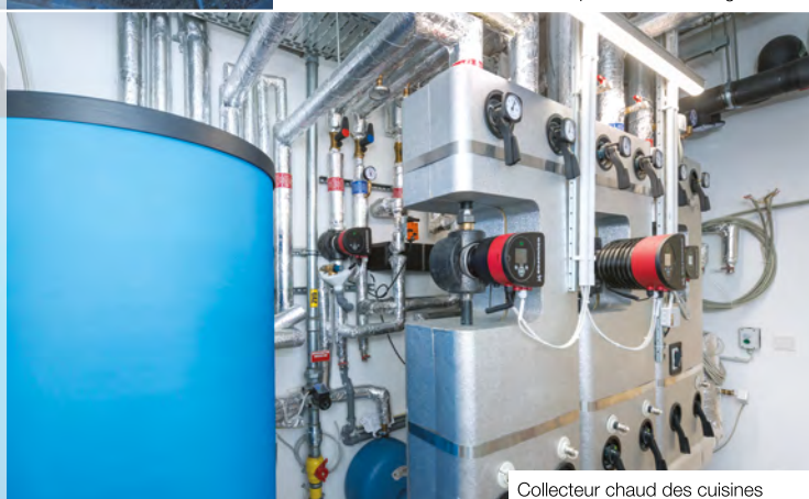
Collecteur chaud des cuisines
