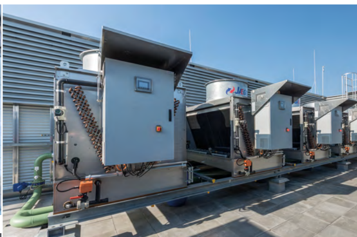
Tours de refroidissement
