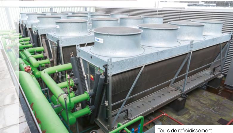
Tours de refroidissement
